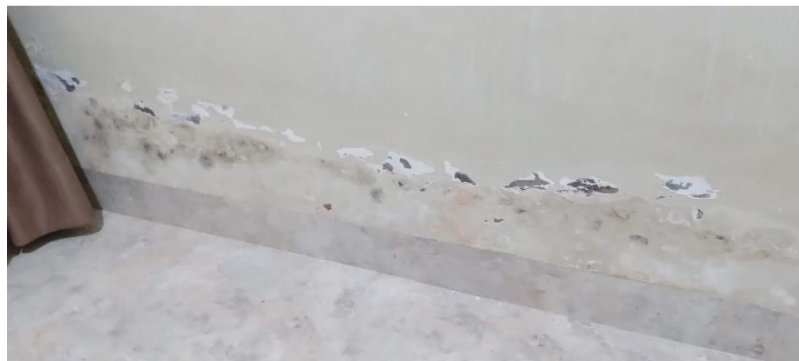
Gambar 3. Dinding bercak, terkelupas dan basah di sebelah kamar mandi Sumber: Penulis 2019
