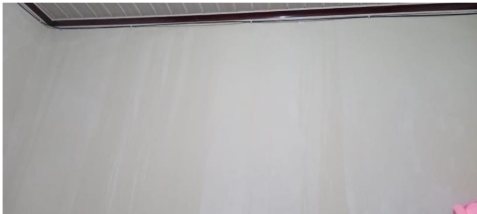
Gambar 5. Bekas air yang mengalir pada dinding dari atap yang bocor Sumber: Penulis, 2022
