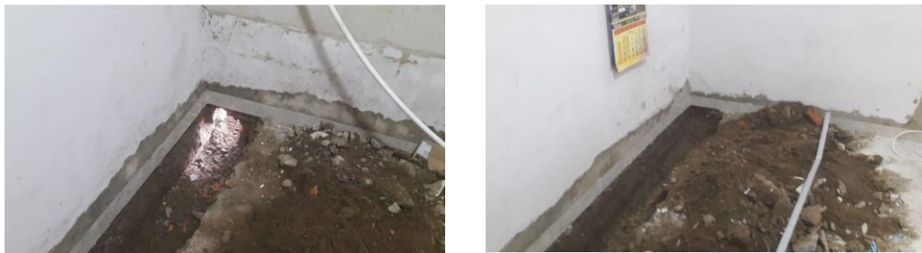
Gambar 6. Galian tanah untuk pembuatan jalur atau tray Distribusi buangan air hujan. Sumber: Penulis, 2019
