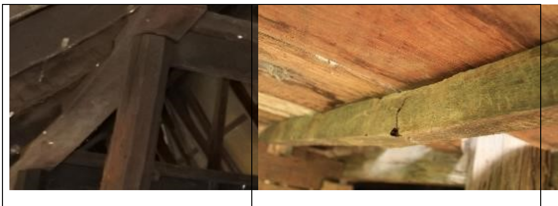
Gambar 3. (kiri) Retakan/pecah pada ujung tiang; (kanan) Retak/pecah pada balok lantai
